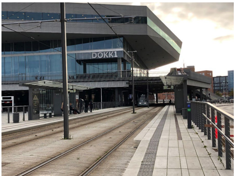
Abbildung 7 Einfachfahrleitung mit Seilgleiter, Mittelmast, hier mit doppelter Fahrleitung (Beispiel Aarhus)
